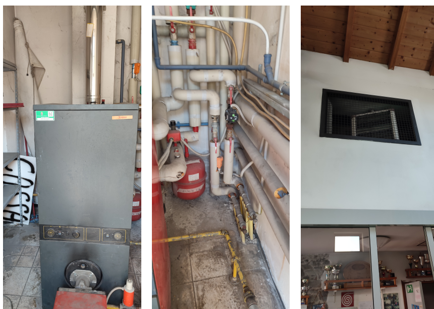
Foto 3: Particolari generatore, distribuzione primaria e aerotermo zona palestra.
