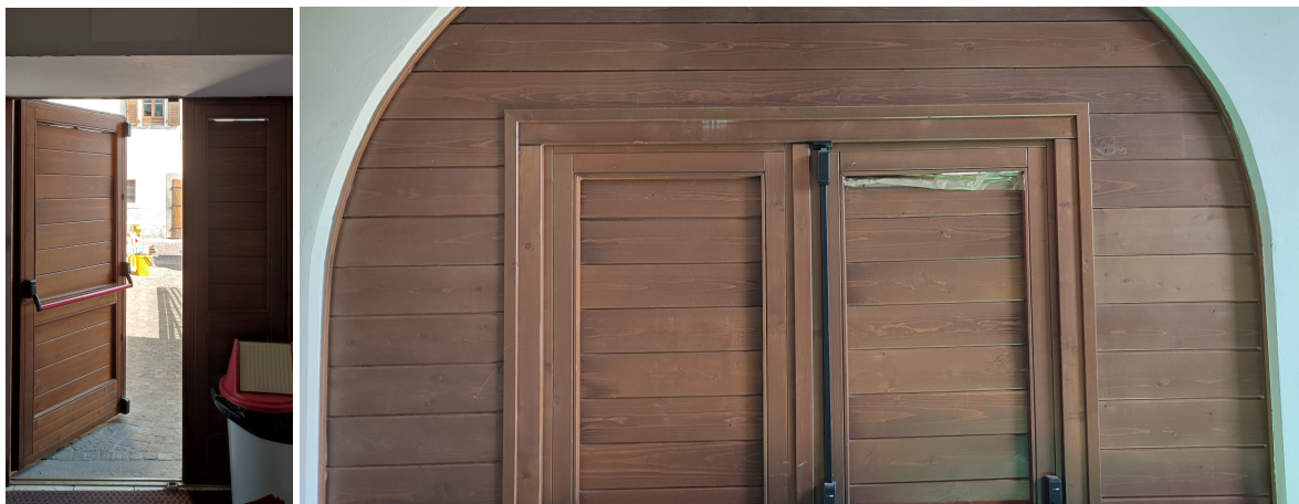
Foto 5: Particolari degrado portoncini accesso piano rialzato.
