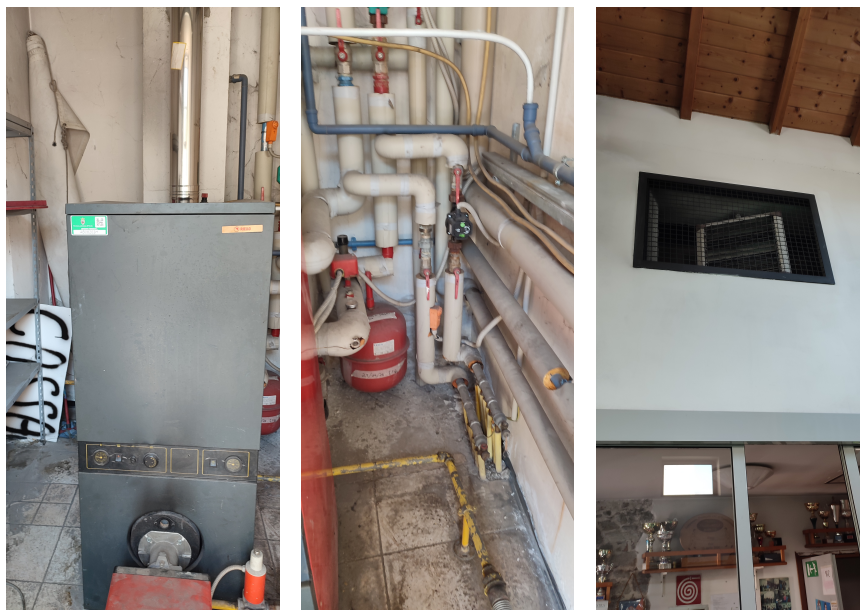
Foto 7: Particolari generatore, distribuzione primaria e aerotermo zona palestra.
